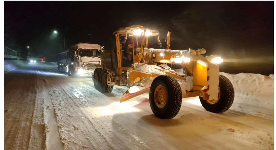
(令和6年2月 国道17号 群馬県みなかみ町)
